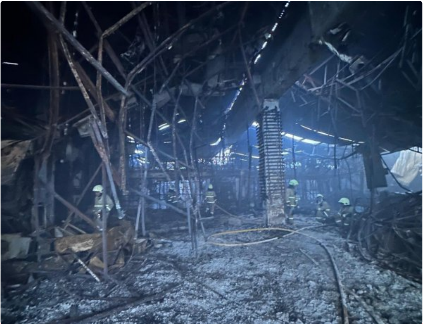
Glodok Plaza yang Hangus Terbakar
